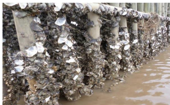
Hình 7. Cọc tre bị sinh vật hại phá hủy ở biển Tây, tỉnh Cà Mau
