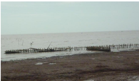
Hình 4. Tường mềm tại thành phố Bạc Liêu, tỉnh Bạc Liêu
