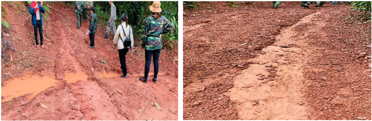
Hình 7. Hiện tượng xói mòn, sạt lở và nước mưa đọng trên các tuyến đường vận xuất
