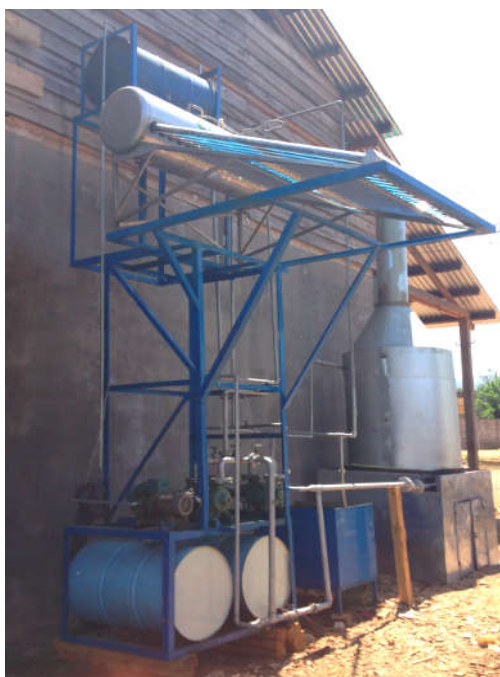
Hình 4. Hệ thống cấp nhiệt cho lò sấy bằng năng lượng mặt trời kết hợp nồi dầu
